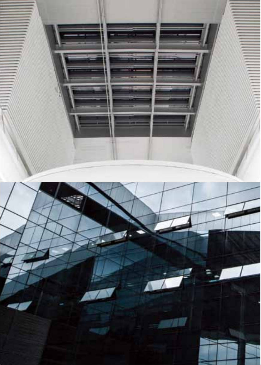
유리 상자의 딜레마. 빛이 무차별적으로 들어오니 건물 내부 온도는 온실처럼 올라가 에너지 소모도 크고 공기 질도 낮아진다. 이에 반해 테크노돔은 빗물 들일 부분은 뚫고 막을 부분은 가렸으며, 열릴 부분은 잘 열고 닫을 부분은 잘 닫아 온실화도 억제하고 쾌적함을 높였다.
